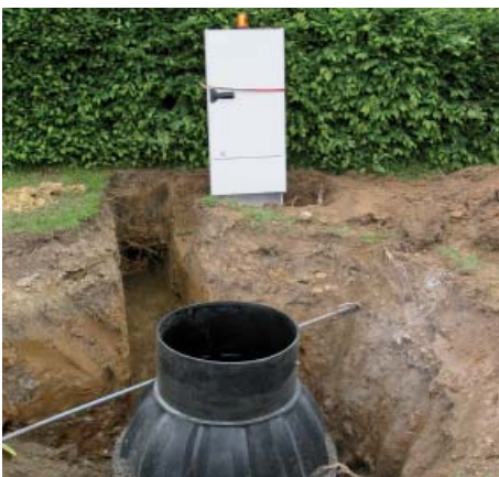
Pumpschacht und Schaltschrank
