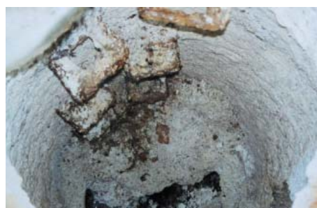
Durch Schwefelwasserstoff korrodierter Schacht
