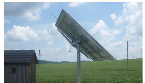
astronomisch gesteuerte Anlage
