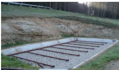
Bodenfilter Kläranlage Schagges
