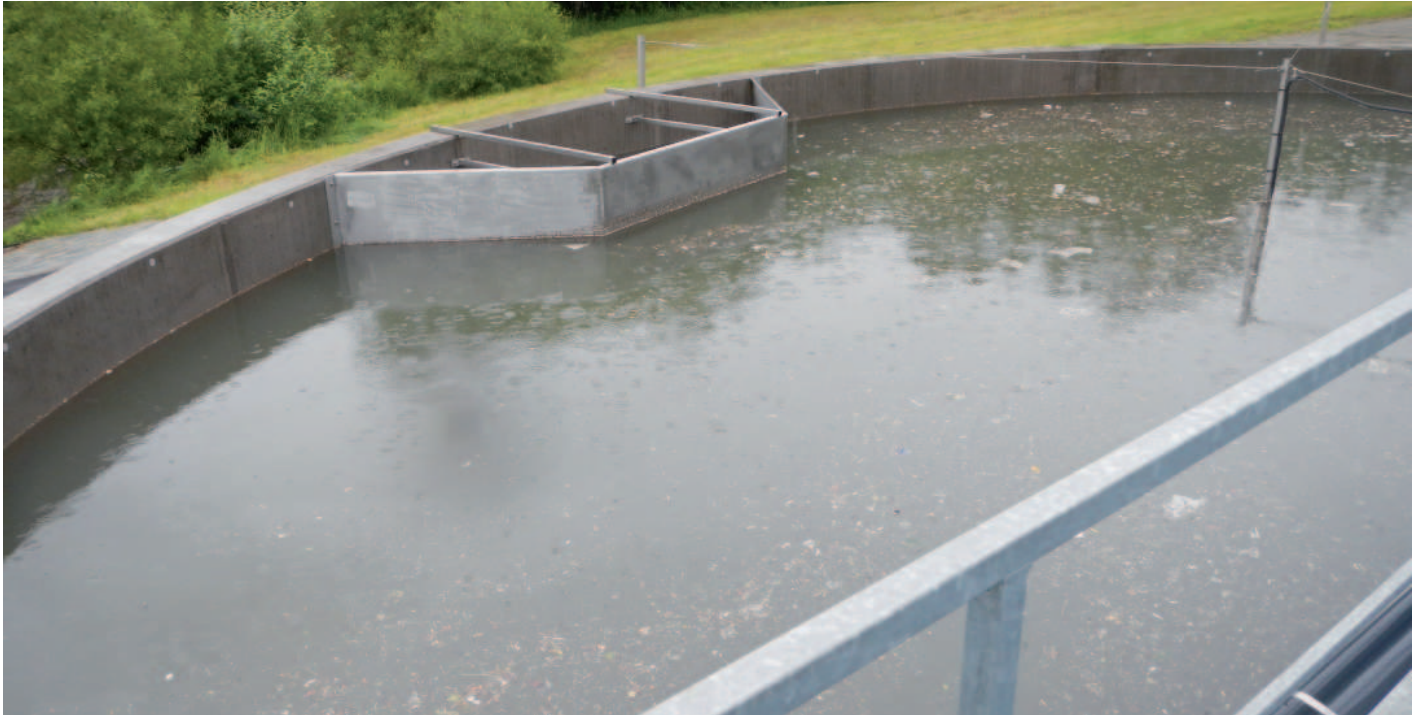
Regenüberlaufbecken bei Vollfüllung
