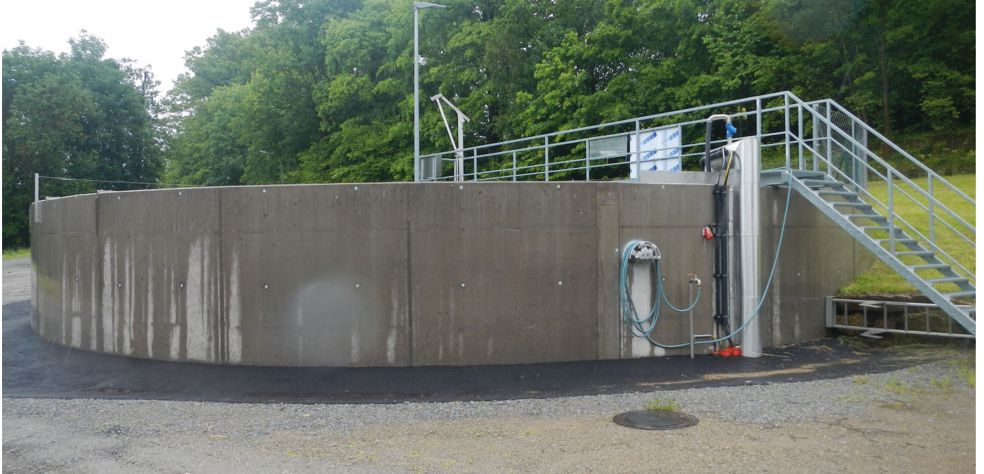
Regenüberlaufbecken der Stadtgemeinde Weitra
